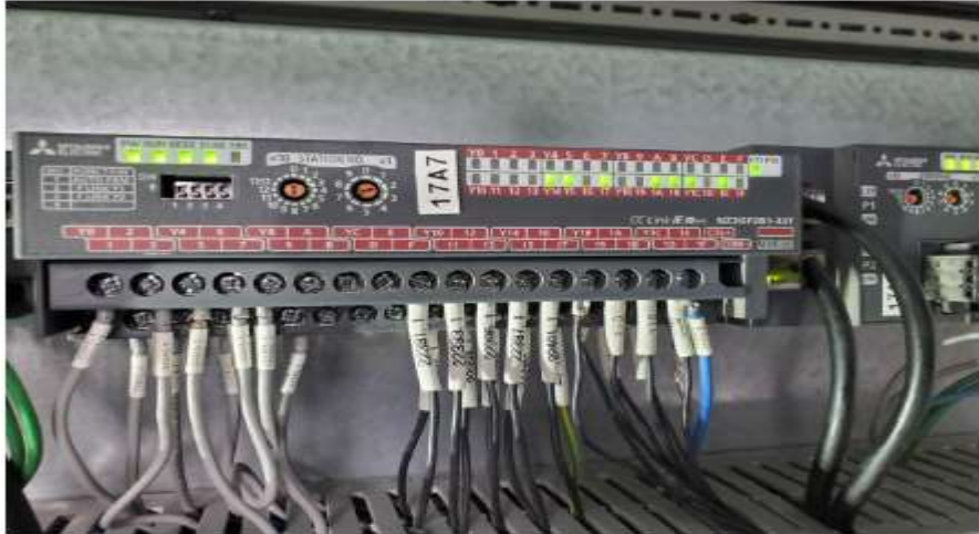
Ilustración 5.15: Cableado de señales. Fuente: Propia.
