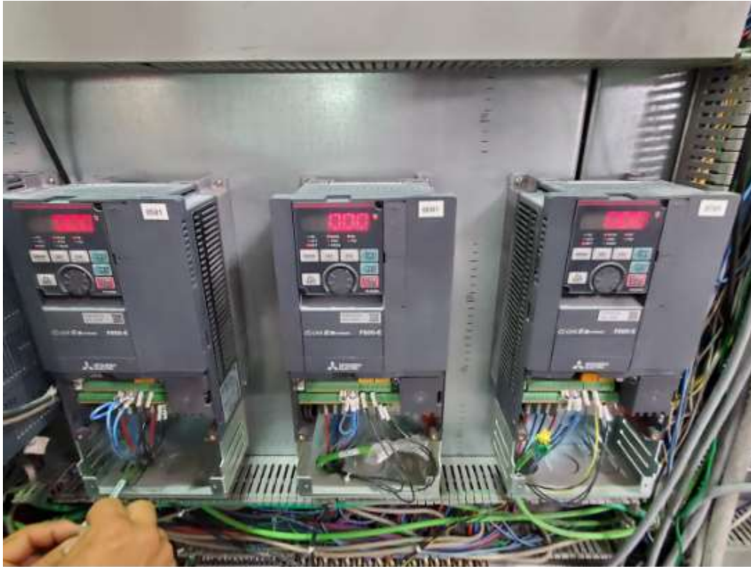
Ilustración 5.14: Controladores. Fuente: Propia.
